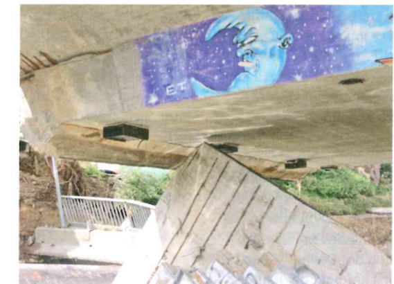
5 Havariierter Zustand des Überbaus © Becker Ingenieure GmbH
