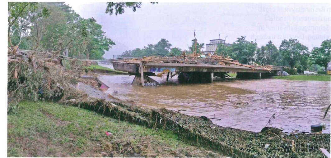
4 Verklauter Durchflussquerschnitt mit Umspülung des südlichen Widerlagers © Becker Ingenieure GmbH
